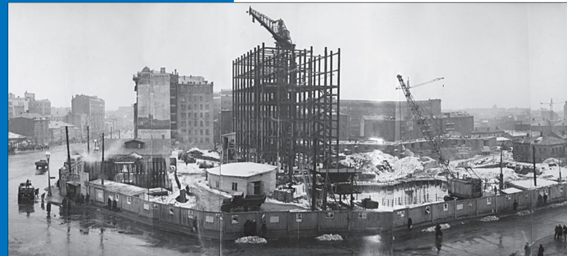
1950 год. Вид стройплощадки высотки у Красных ворот со стороны Каланчевской улицы. В центре — стальной каркас высотной части здания, правее от него — котлован под вестибюль метро. Фото из личного архива Игоря Дормана. Публикуется впервые.
